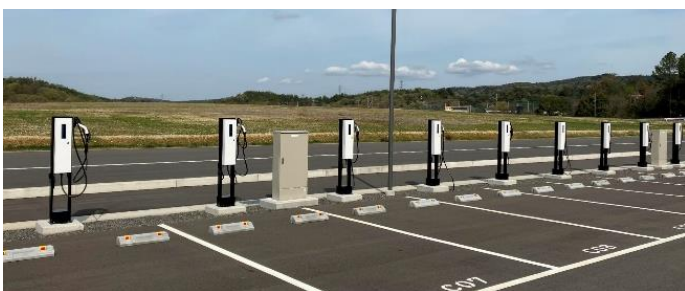
社員駐車場に設置しているEV充電設備
