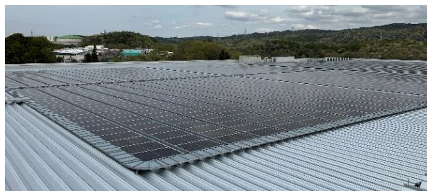
工場の屋根に設置している太陽光発電システム (パネル容量1,312 kW)
