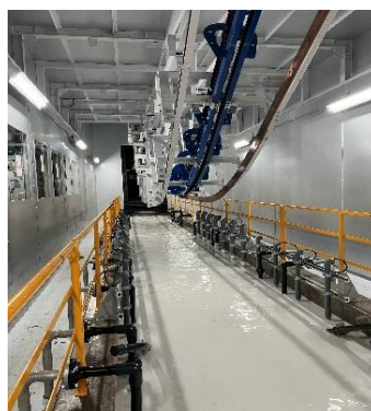
導入された塗装設備
