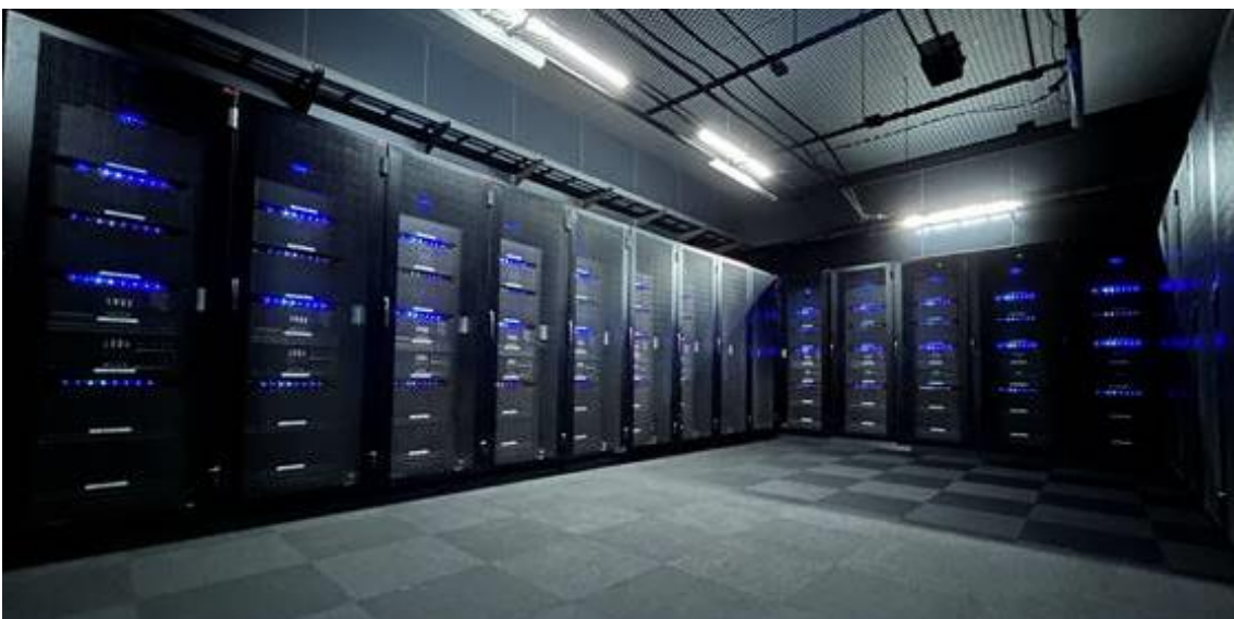
サーバールームに設置された「システムラック AH シリーズ」
