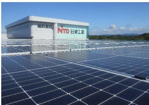
設置された太陽光パネル
