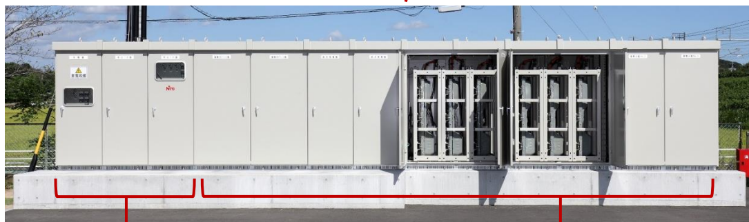
既存キュービクル
