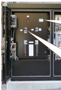
天守入口付近に設置されている 分電盤
