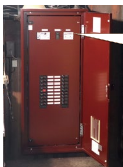
本堂(国宝)に設置されている分電盤
