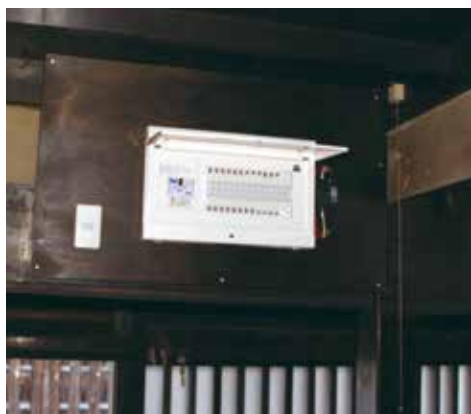
感震ブレーカー(感震リレー付ホーム分電盤)設置事例
