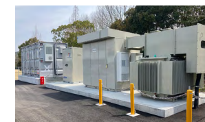
太陽光併設蓄電所(FIP)
