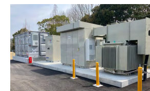
太陽光併設蓄電所 (FIP)
