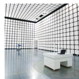
10m法電波暗室
