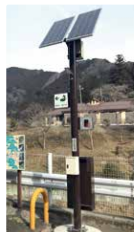
■独立電源システム 東京都檜原村設置事例
