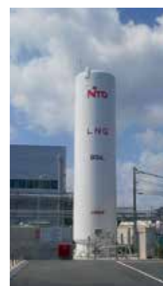
菊川工場LNG設備
