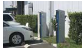
従業員向けEV・PHEV用充電設備
