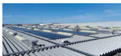
太陽光発電設備(掛川工場)
