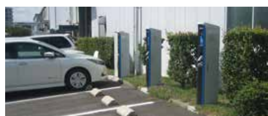
■従業員向けEV・PHEV用充電設備
