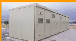
高圧受電設備
