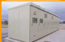
高圧受電設備
