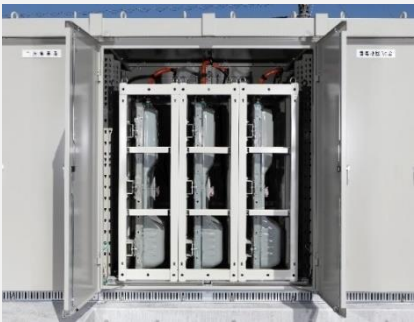
EVリユースバッテリーパックを搭載した蓄電池
