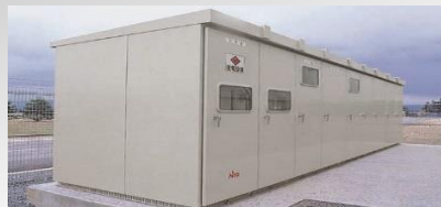
高圧受電設備
