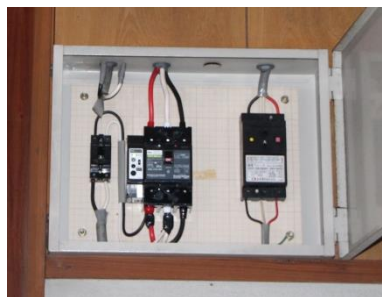
感震ブレーカー設置状態
