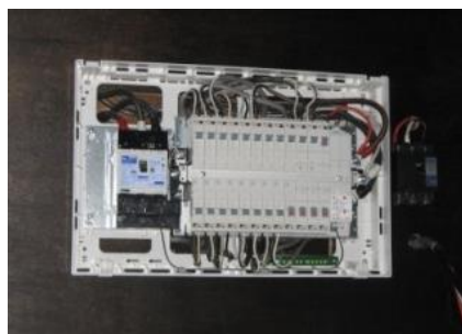
感震ブレーカー 設置状態 (感震リレー付ホーム分電盤)
