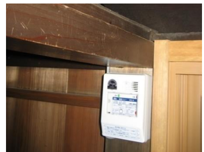
感震ブレーカー（既設用）設置状態 感震リレー（MG4）
